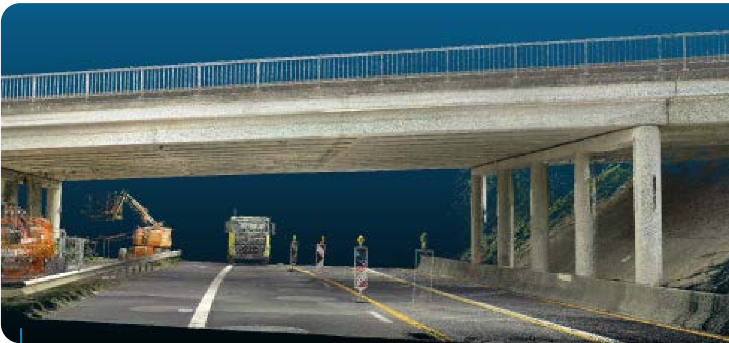
De combinatie van fotogrammetrie en laserscanning levert een puntenwolk op die de brug minutieus in kaart brengt.
