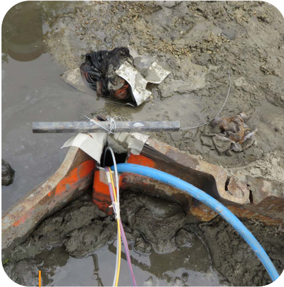
Op de damplanken werd een stalen koker gelast, waarin na installatie van de damplanken de reksensoren werden geplaatst.
