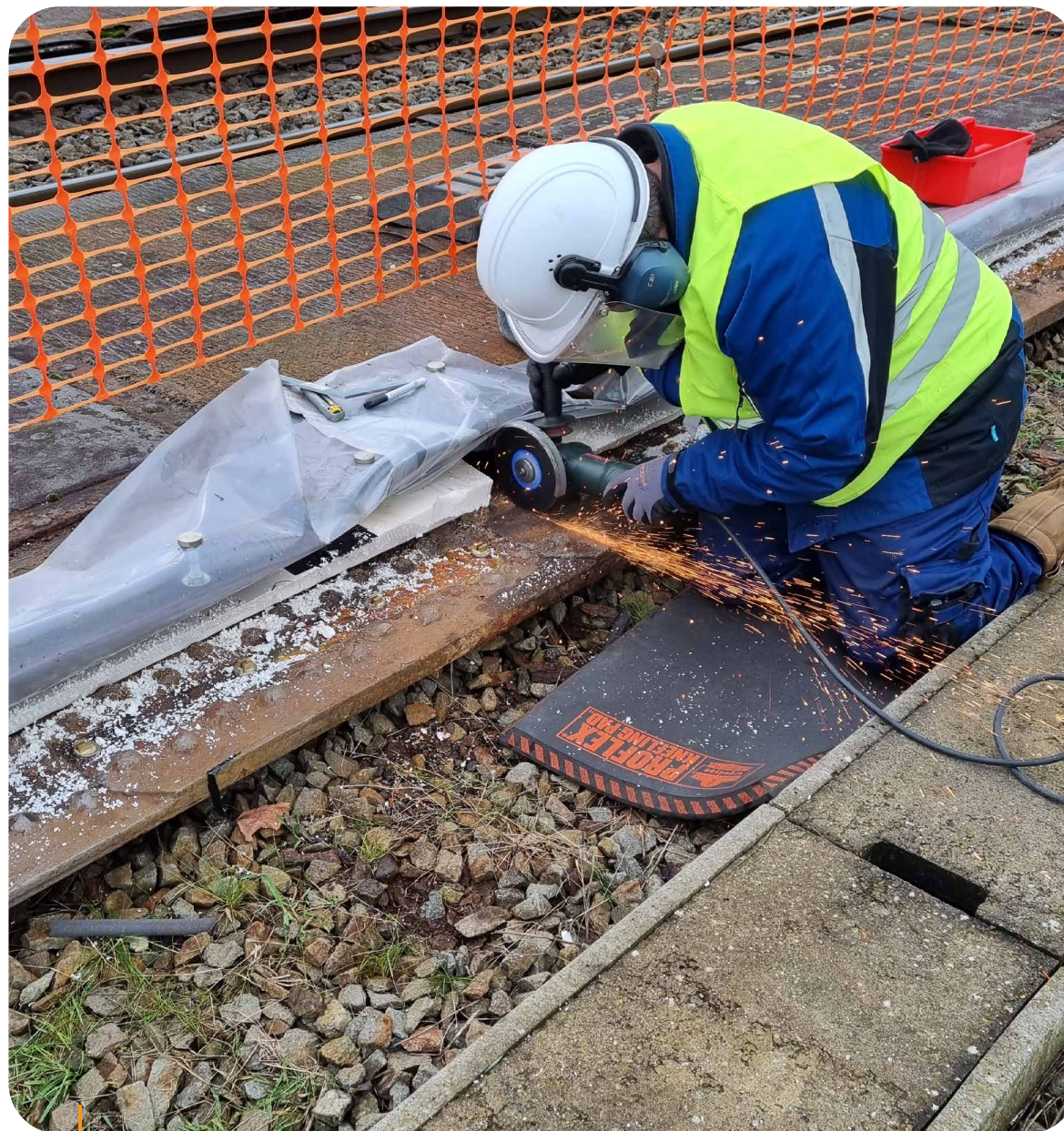
À Renaix, de petites fissures ont été occasionnées au moyen d'une meule dans l'aile supérieure d'une poutre principale.
