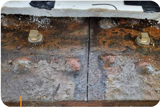
Les déformations dynamiques dans le tablier ont pu être suivies en détail grâce aux capteurs de déformation à fibres optiques.
