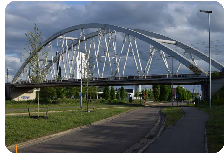
Depuis octobre 2018, les vibrations de l'impressionnant pont du chemin de fer KW51 à Louvain sont mesurées.
