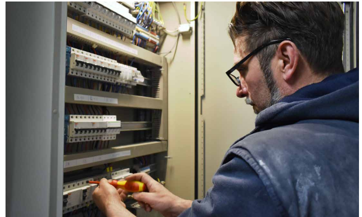
De technische installaties werden volledig op punt gesteld voor de ingebruikname van het gebouw.
