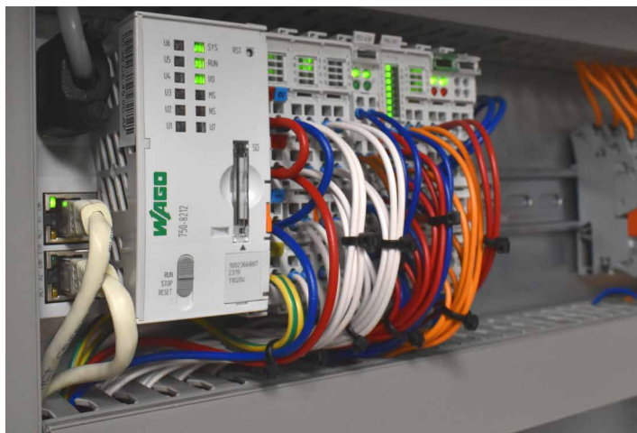
L'outil de gestion multisite utilise un WAGO PLC qui permet de prévoir des I/O (de différents types) en fonction des besoins.
