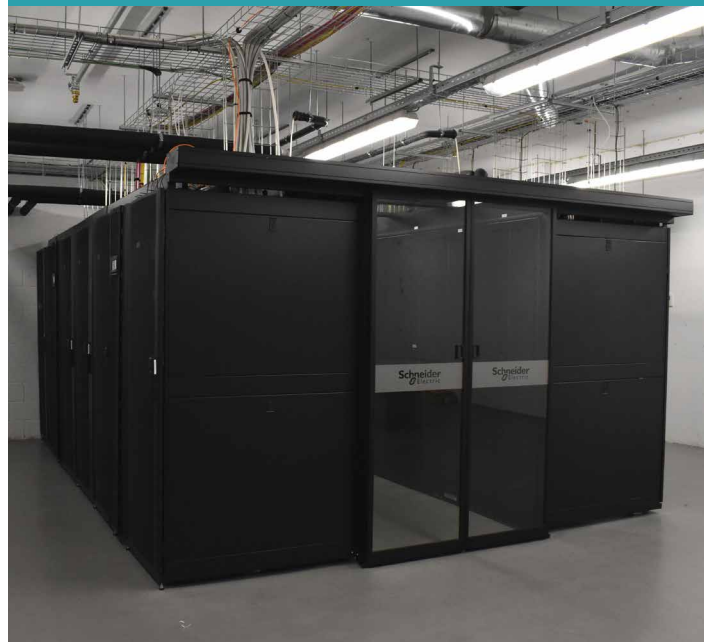
Alles draait op de eigen IT-infrastructuur. Een tweede redundant datacenter kan overnemen mocht het eerste uitvallen.
